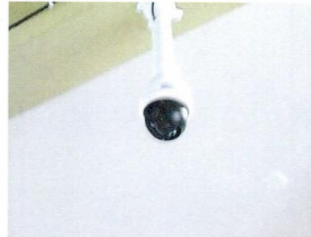
Laboratorio Pesado 2 ubicada en el pasillo
